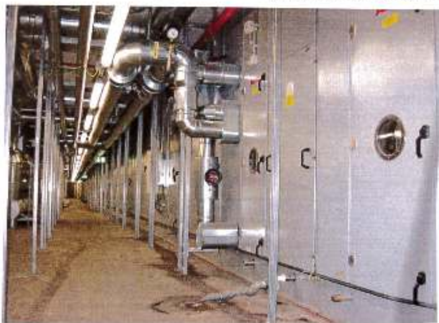
Bild 4: Teilkühlergerät in Technikzentrale
