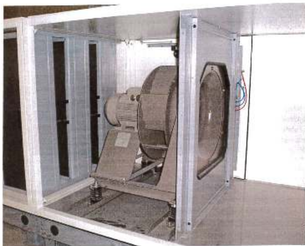
Bild 5: Freilauf-Ventilator im RLT-Gerät
